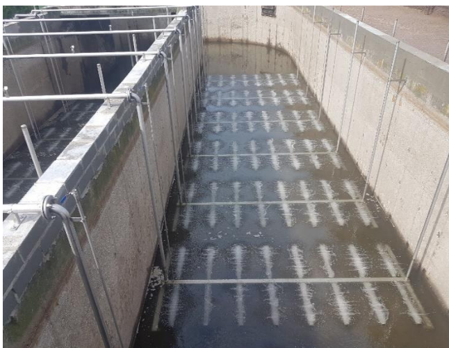
Fot. nr 40, Mechaniczno-biologiczna oczyszczalnia ścieków w Sobolewie
